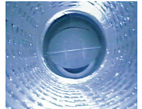
Abluftleitung nach der Reinigung
