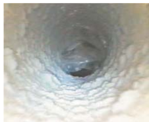
Un canal sale d'alimentation d'air dans un hôpital
